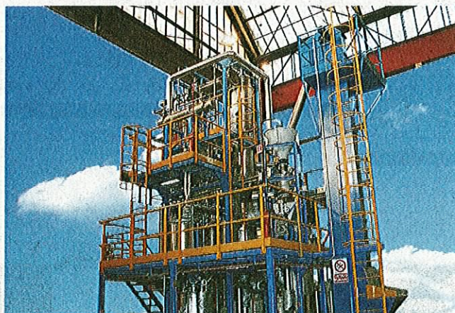
Una veduta dell'impianto realizzato dalla Vuzeta
